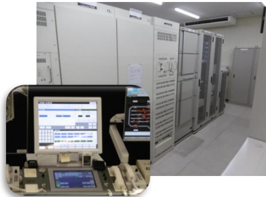
【列車無線設備更新】
